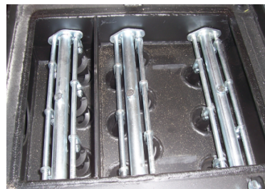
LIMPIEZA TURBULADORES MOTORIZADA EXTRACCION CENIZAS MOTORIZADA
